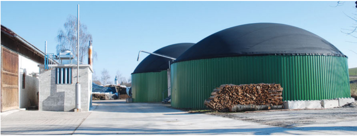
Die Biogasanlage von Hans Grötzinger wird hauptsächlich mit Zwischenfrüchten und Gras gefüttert. Die Abwärme der Anlage wird nahezu vollständig über eine installierte Nahwärmeleitung und eine Trocknungsanlage genutzt.
